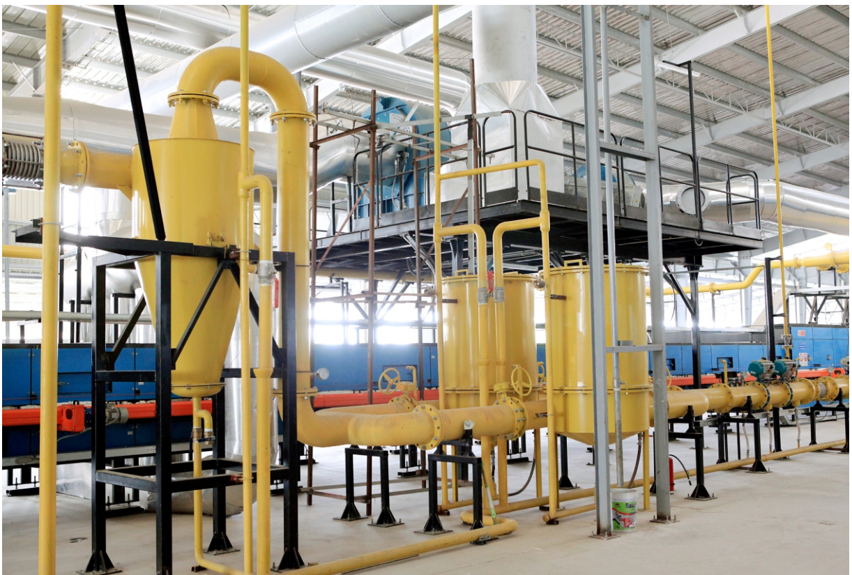
Hệ thống nước ngưng - SACMI - Condensate System SACMI
